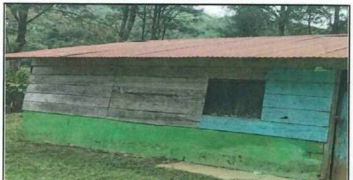
Foto 4: Se observa la necesidad de la sustitucion de ventana de madera por metal mas vidrio.
