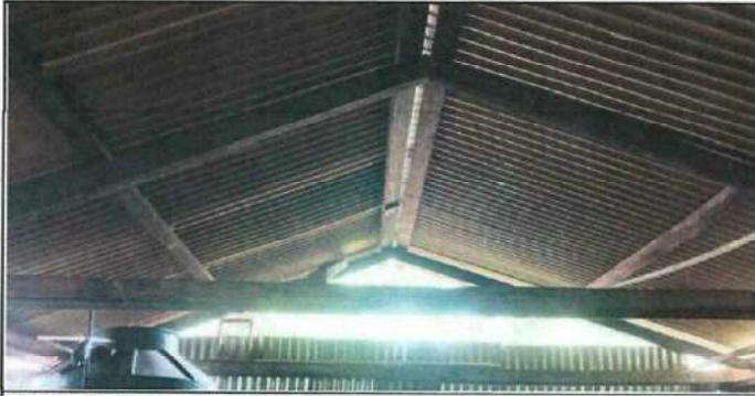
Foto 1: Se observa el techo de la cocina en mal estado.
